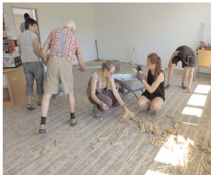
Die Fußböden im Pfarrzentrum sind durch das Hochwasser zerstört worden.
